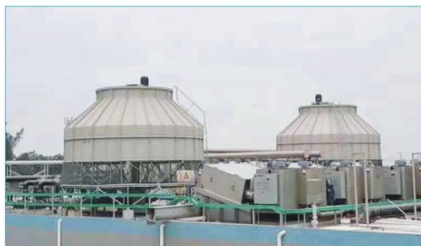
广东厨卫垃圾渗透液处理项目项目 LKT-700×2
