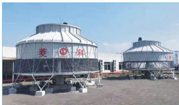
东莞奥日升制造技术有限公司项目 LKT-700×2
